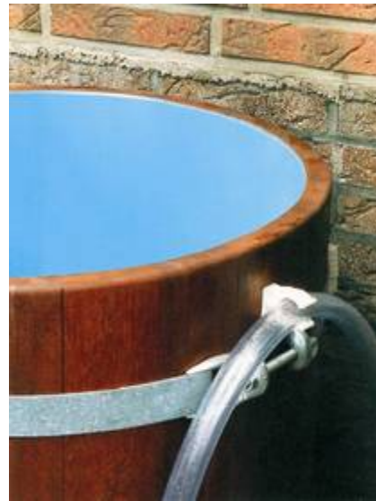
Fixation tuyau de vidange du récupérateur
